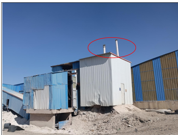
布袋除尘器排气筒高度不足 15m
